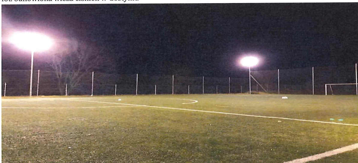
fot. zmodernizowane oświetlenie boiska ORLIK w Stuchowie
